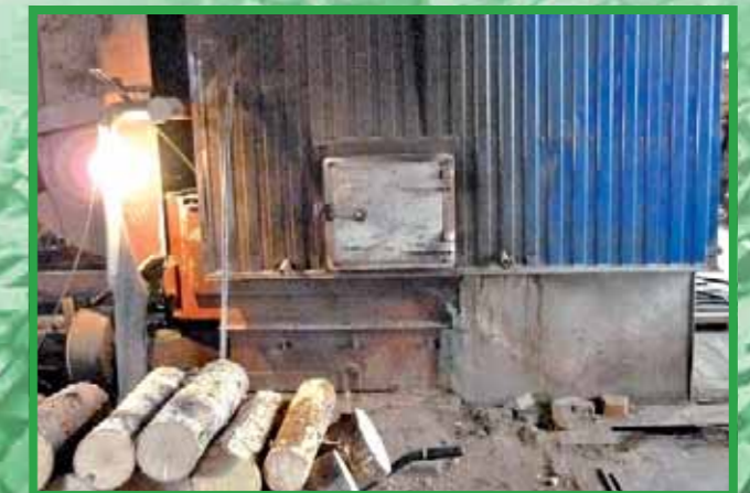
Котельная д. Мошинская
